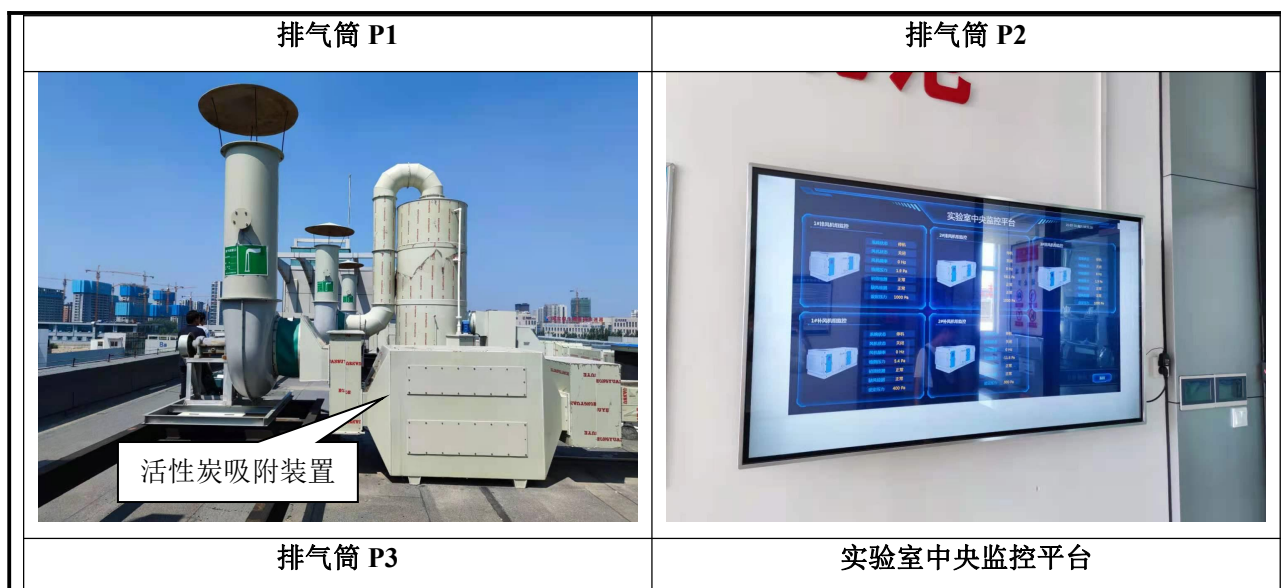
图 3-1 废气处理设施照片
