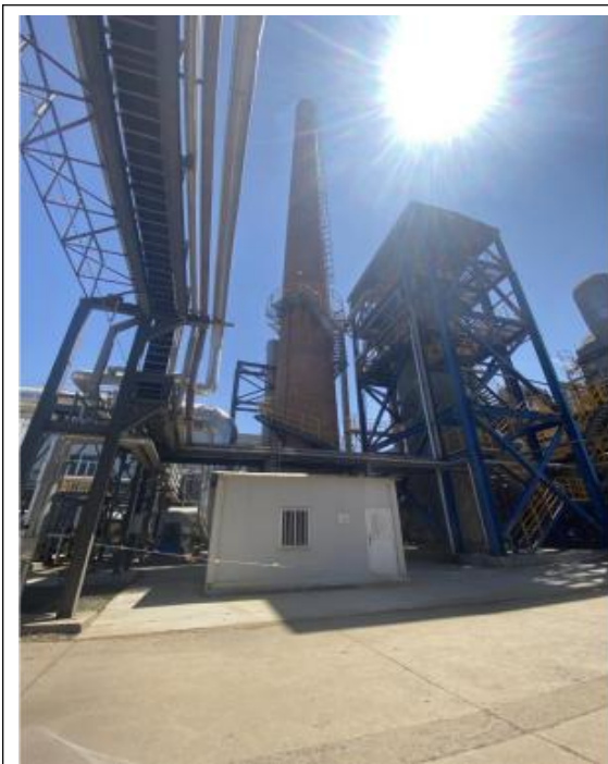
1#RTO 排气筒 DA002
